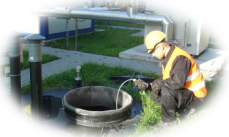
dla służb technicznych
